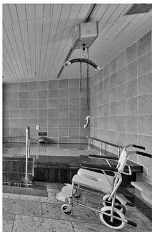
図10 温泉旅館のバリアフリー・ルームの浴室に設置されているリフト
