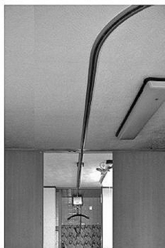
図4 天井に設置してあるリフト用のレール
